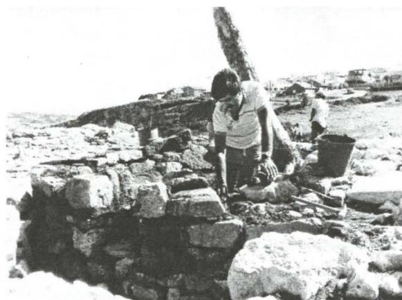
2. Pormenor dos trabalhos de restauro e consolidação de estruturas arqueológicas, realizados em Leceia.
