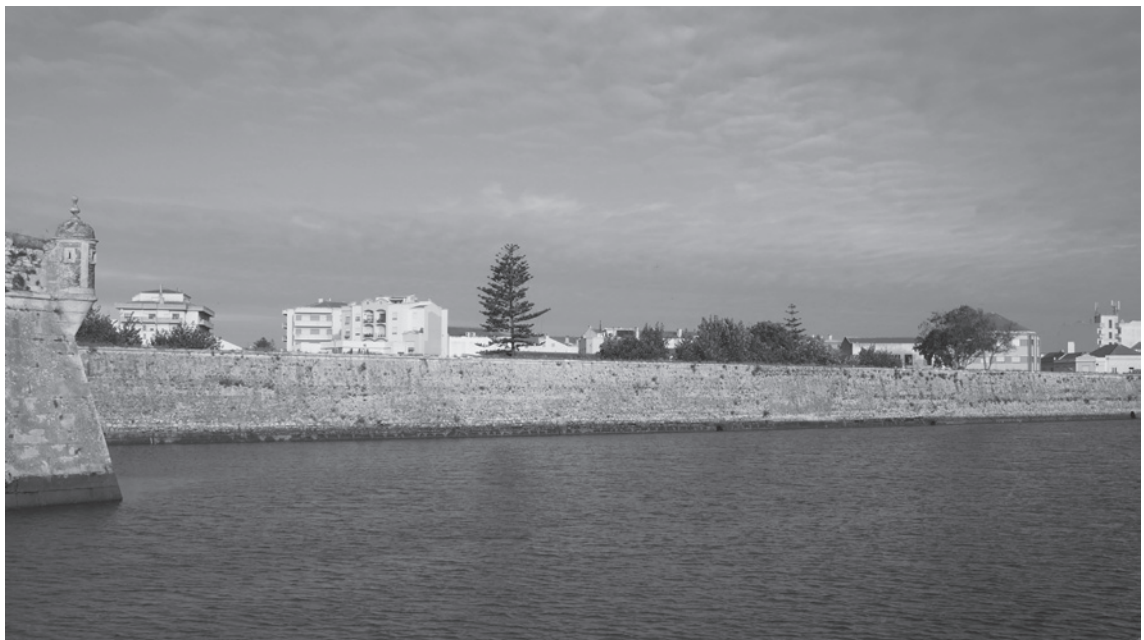
Figura 3 – Zona da muralha que ruiu.
